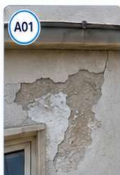
Degrado localizzato dell'intonaco sulla facciata sud.
