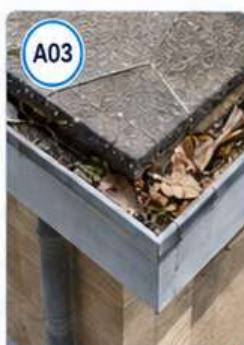
Accumulo di detriti in gronda e pluviale parzialmente ostruito.
