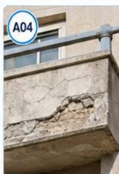
Degrado del frontalino balcone con distacco intonaco.
