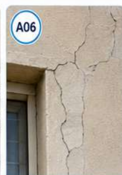
Fessurazioni verticali e distacchi di intonaco localizzati.
