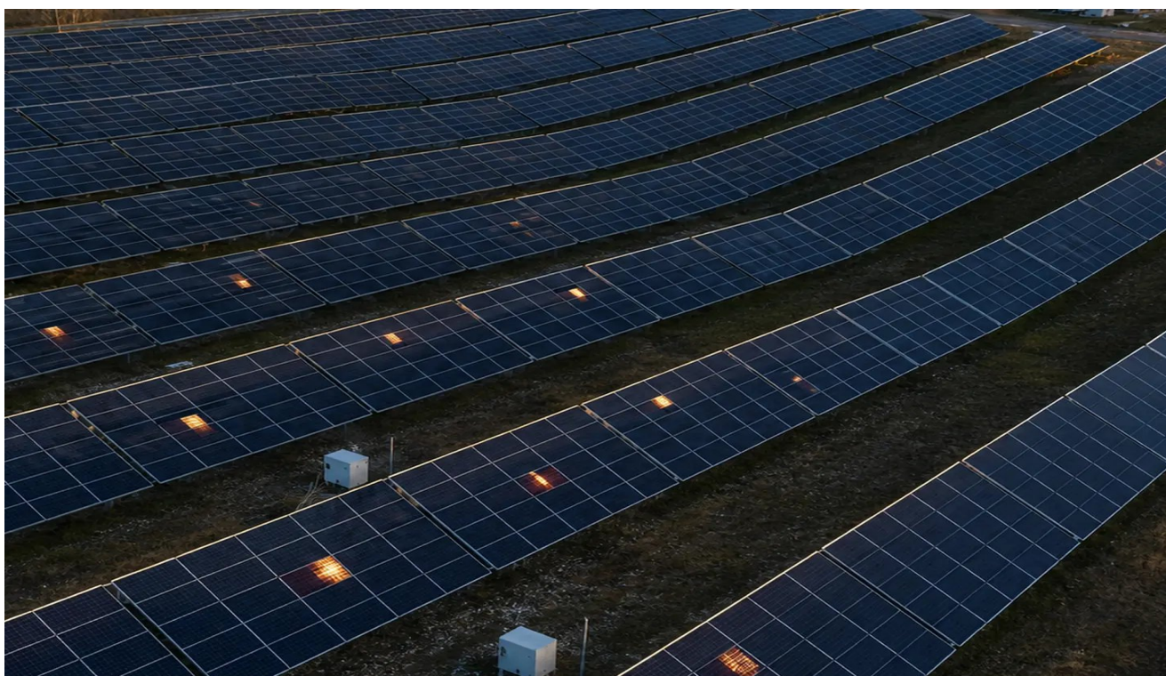
Campo fotovoltaico al crepuscolo: le celle in riscaldamento anomalo emergono rispetto ai moduli adiacenti.
